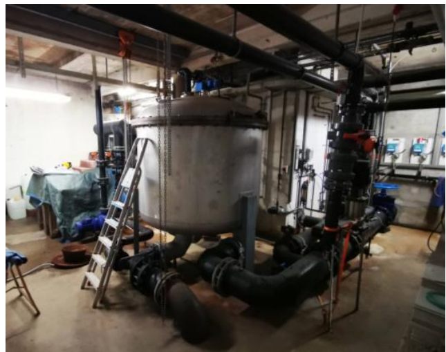
Illustration 1 – Installation actuelle de filtration
