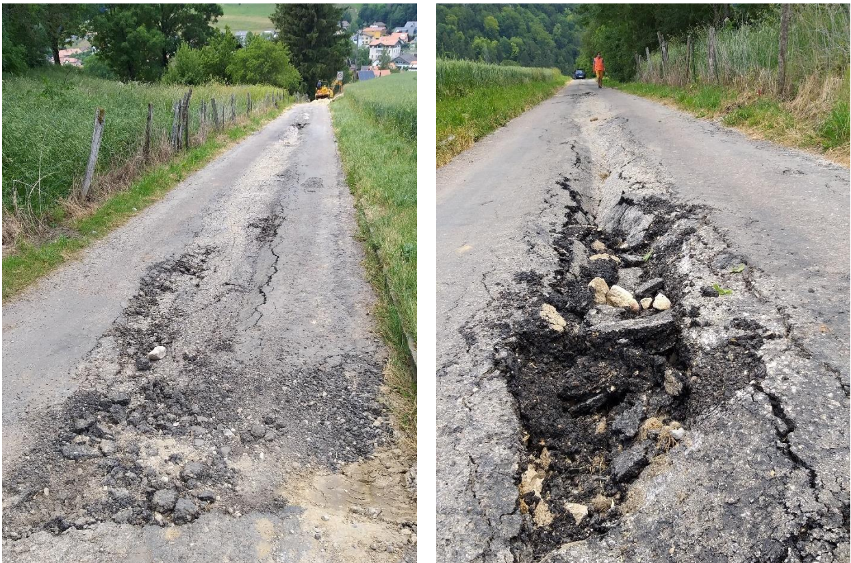
Figure 6 : Dégâts sur la Venelle des Moulins à la suite du débordement du Seyon en 2019
