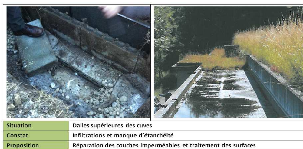
Figure n°2 : Dalles supérieures des cuves
