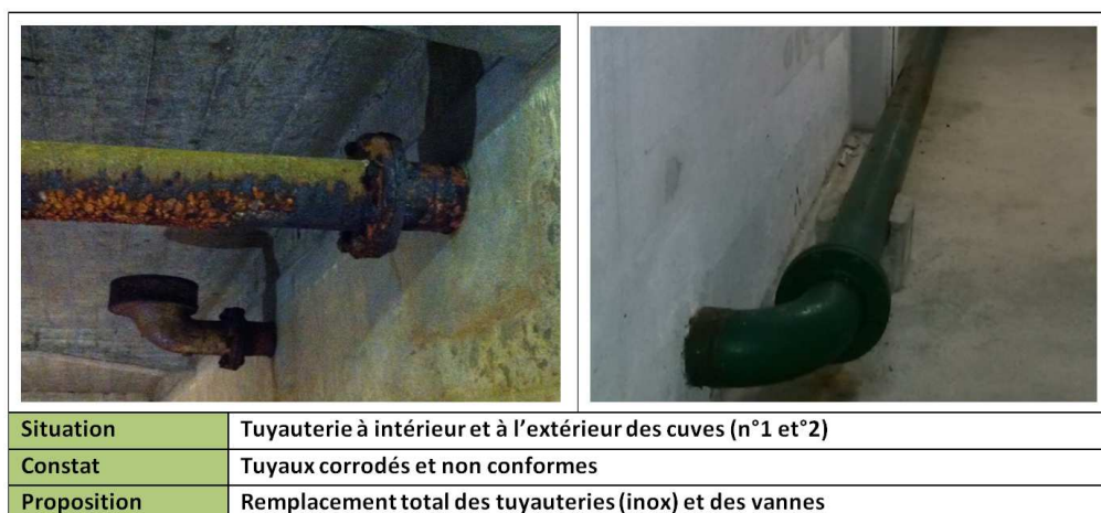
Figure n°4 : Tuyauterie à l'intérieur et à l'extérieur des cuves n°1 et n°2
