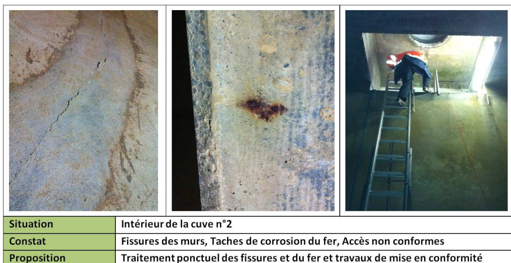
Figure n°5 : Constats à l'intérieur de la cuve n°2
