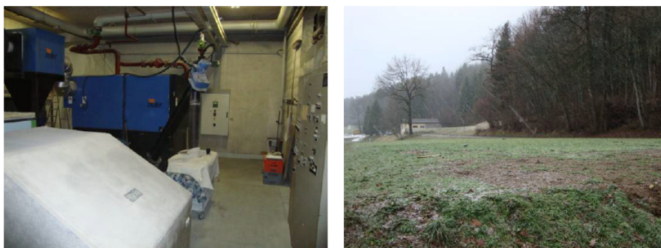
Figure 2 : Chaufferie actuelle (à gauche) : manque de place pour de nouvelles chaudières, accès par le nord du collège (à droite)
