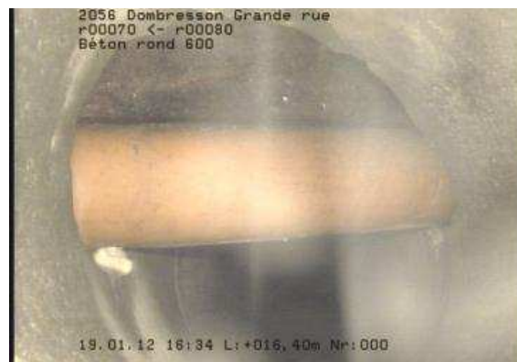
Photo 4 : obstruction importante du collecteur par un raccordement privé
