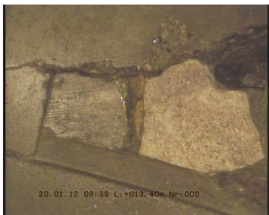
Photo 1 : dégâts sur le collecteur
