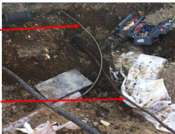
Exemple de câble sous la route du Seyon
